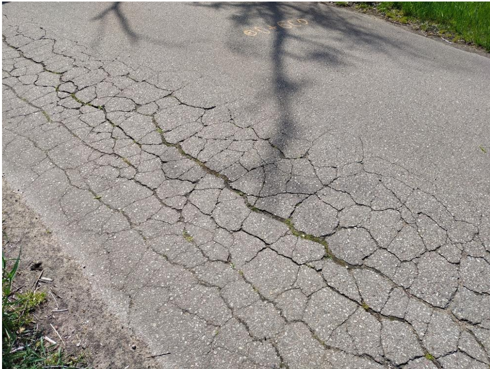
Ubytki przed modernizacją drogi
